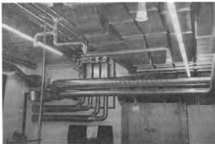
Фрагмент кондиционера, находящегося в подвале музея Института Байелера в Ритене, под Базелем; архитектор Ренцо Пиано. 1997 г.
